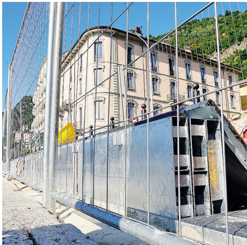
Le prime prove delle barriere antiesondazione effettuate nel settembre scorso a Sant'Agostino
