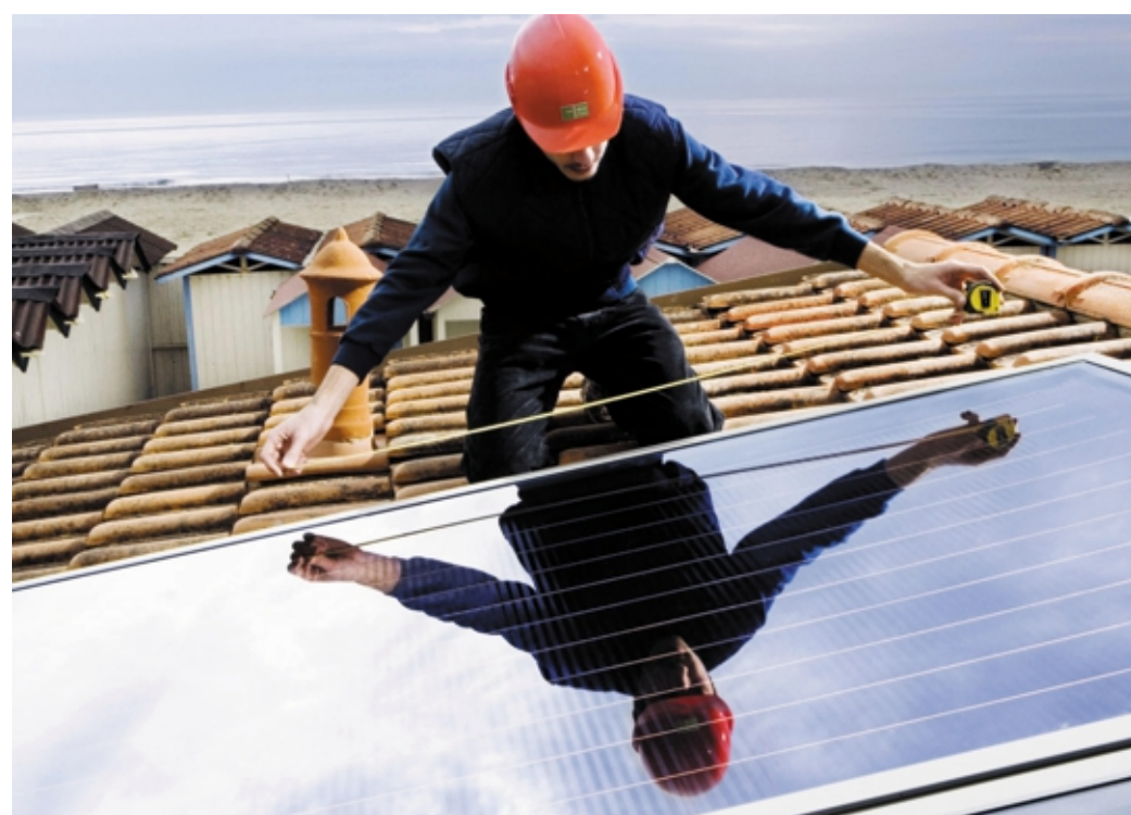
Un operaio su un tetto lavora alla posa di pannelli fotovoltaici ANSA
